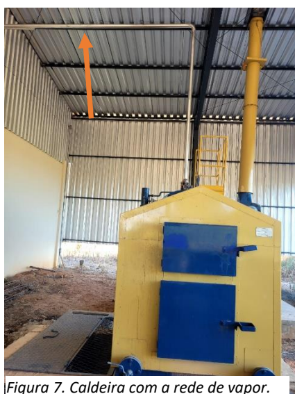
Figura 7. Caldeira com a rede de vapor.
