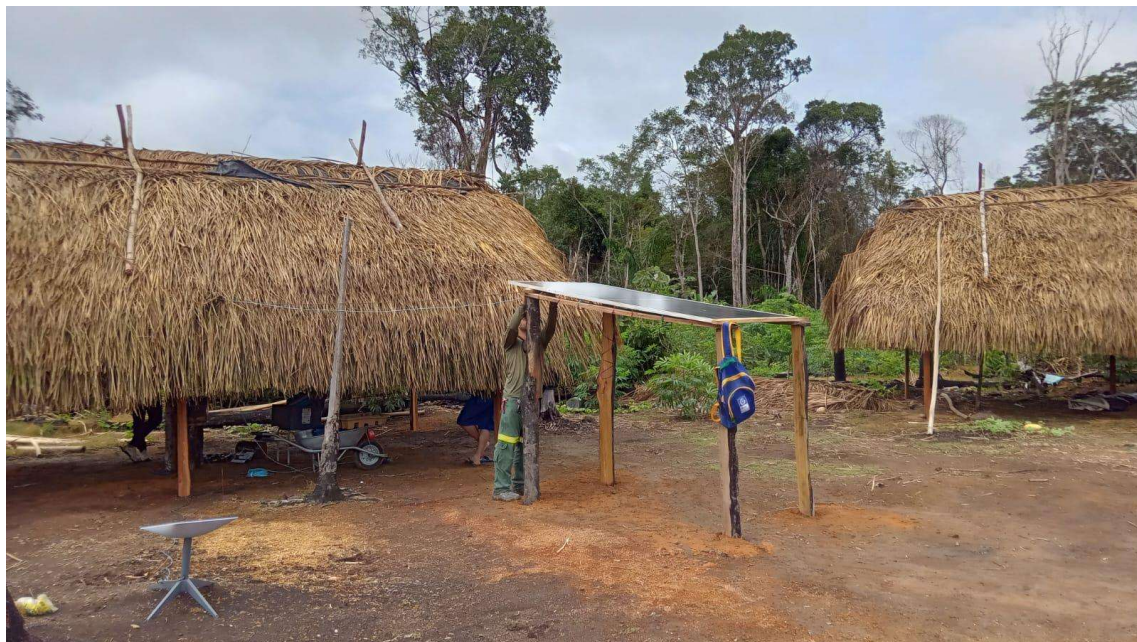
Figura 1. Momento da instalação da placa solar para a antena da internet na aldeia Kadjatnhõrõ. Fotografia: Roiti Metuktire.
