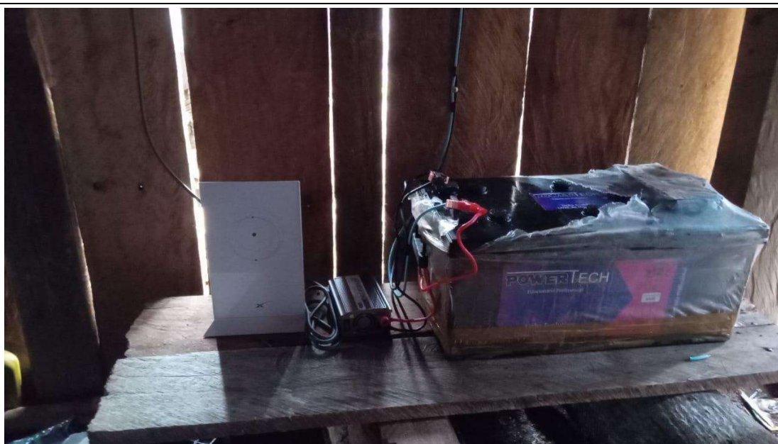
Figura 6. Roteador da antena, instalado na aldeia Poreby. Fotografia: Roiti Metuktire.
