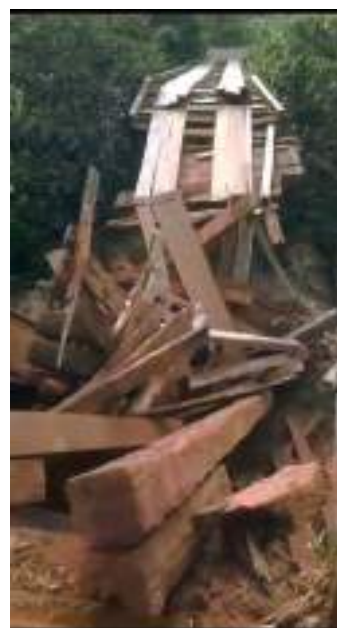
Imagem 15: queda da ponte que dá acesso à aldeia, registro em 20.12.23.
