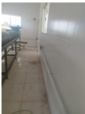
Figura 2 - Instalação elétrica na fábrica;
