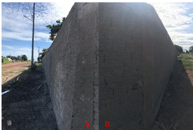
Figura 8. Muro de proteção da Agroindústria de frutas. A) Visão paralela a Avenida Perimetral, e B) Visão paralela a rua dos Marmeleiros (Fonte: Arquivo da Associação AGRIPAC) (20/02/2025).
