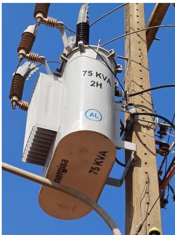
Figura 3. Transformador novo, substituído em razão da ampliação da demanda da agroindústria (Fonte: Arquivo da Associação AGRIPAC) (28/08/2024).
