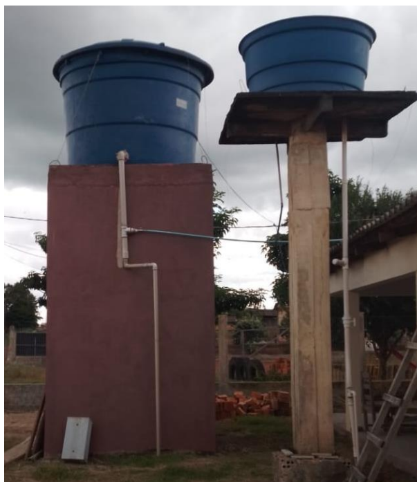
Figura 4. Bases para caixas d'água (Fonte: Arquivo da Associação AGRIPAC) (03/02/2025).
