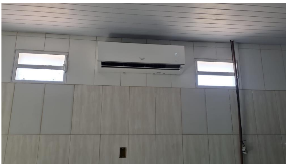
Figura 4: Aquisição de ar condicionado para a sala de processamento
