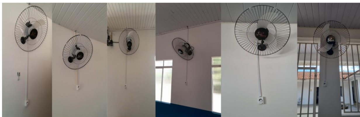
Figura 6: Aquisição de ventiladores
