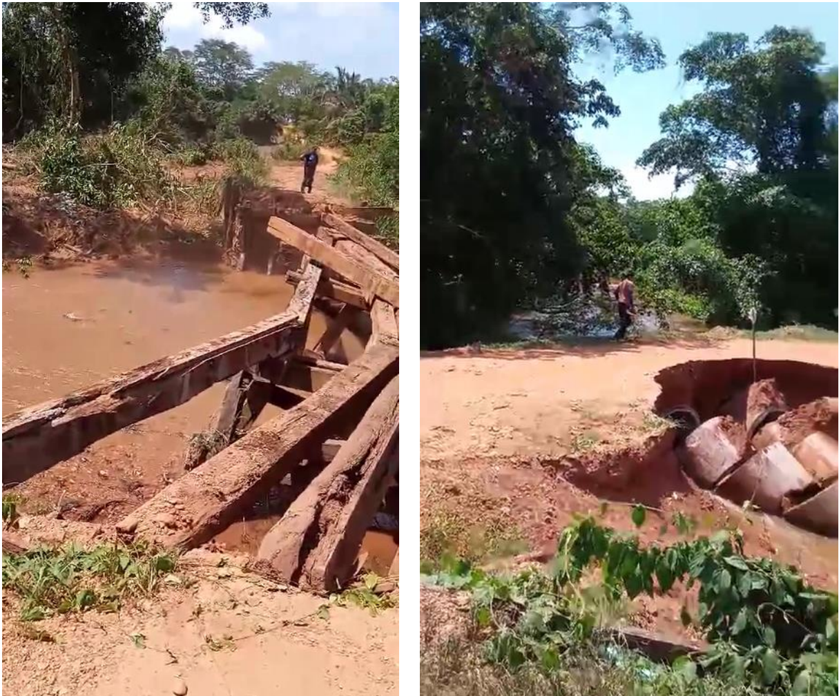
Figura 41: Ponte quebrada e manilhas impedindo o fluxo do rio.
