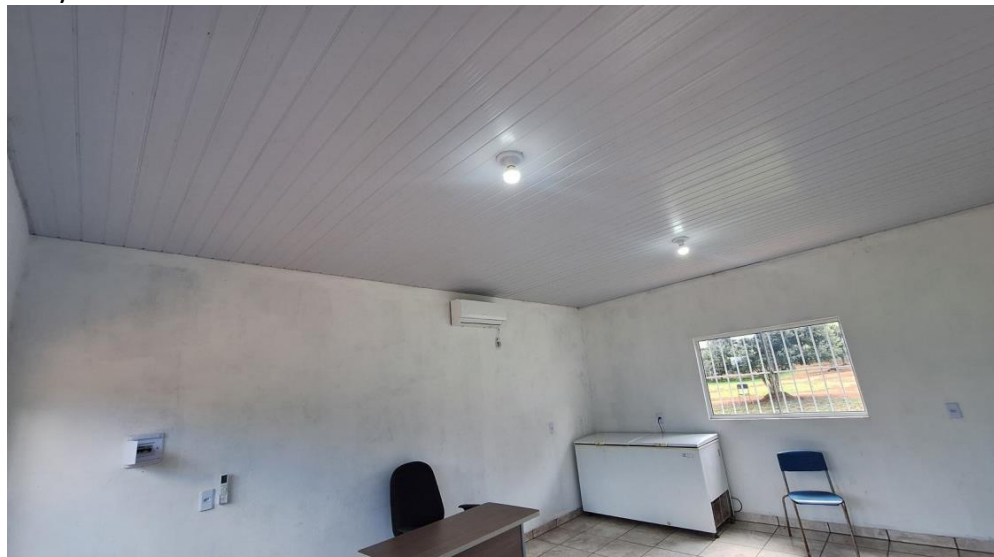
Figura 38: Instalação elétrica no escritório na sede da Associação Indígena Associação Indígena Inhá Apiaká, Aldeia Mayrob – Juara-MT.
