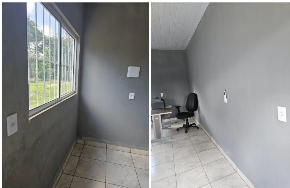
Figura 39: Instalação elétrica no escritório na sede da Cooperativa Munduruk, aldeia Nova Munduruku – Juara-MT.
