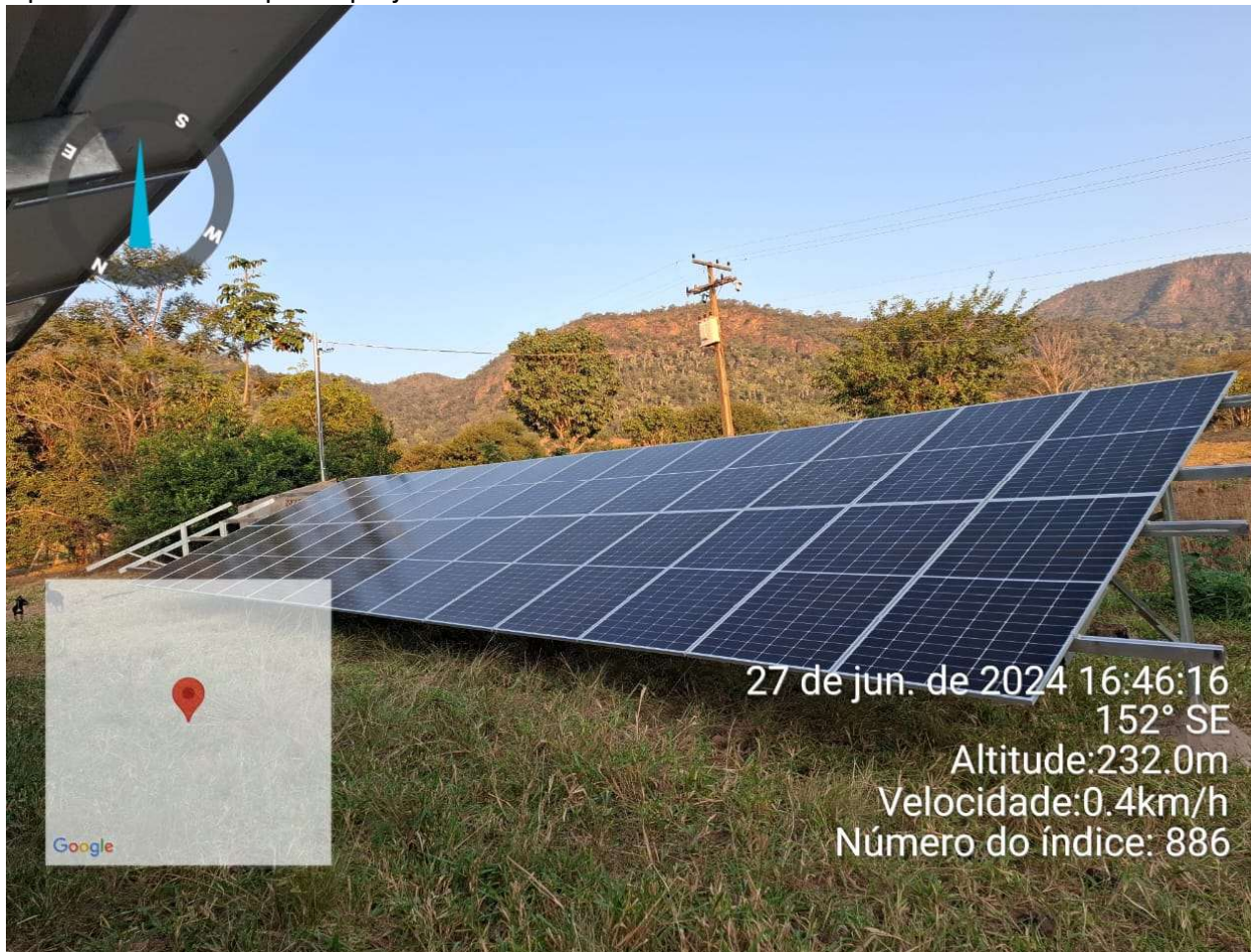
Figura 06: Foto das Placas Solares instaladas e gerando energia.
